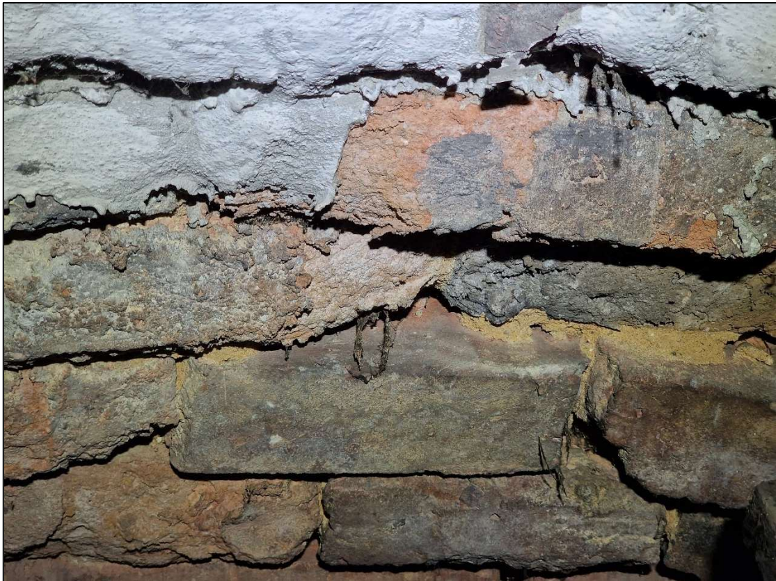
Rys 14. Ubytki i degradacja sklepień
