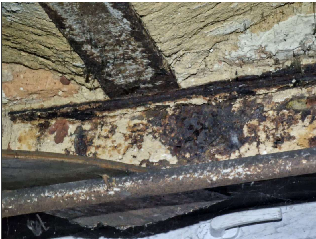
Rys 6. Przegnite stalowe nadproże okienne
