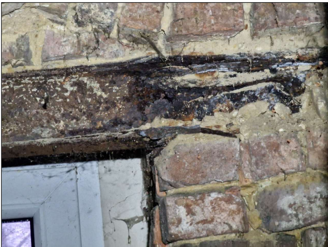
Rys 15. Przegnite stalowe nadproże okienne - pomieszczenie nr 1
