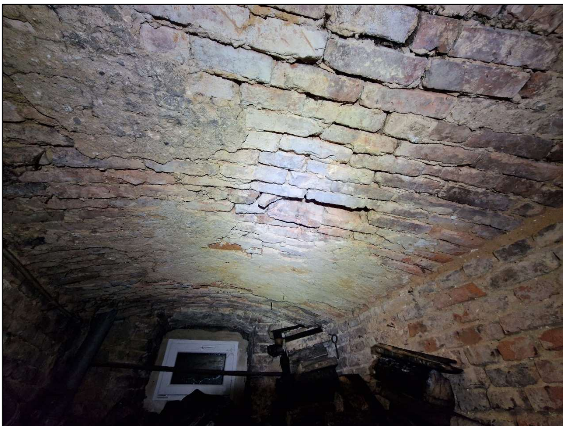
Rys 7. Silne zdegradowane i zdeformowane sklepienie ceglane w pomieszczeniu nr 10
