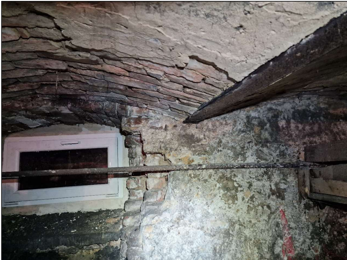
Rys 12. Ubytki i degradacja sklepień, zbutwiałe stalowe elementy stropu
