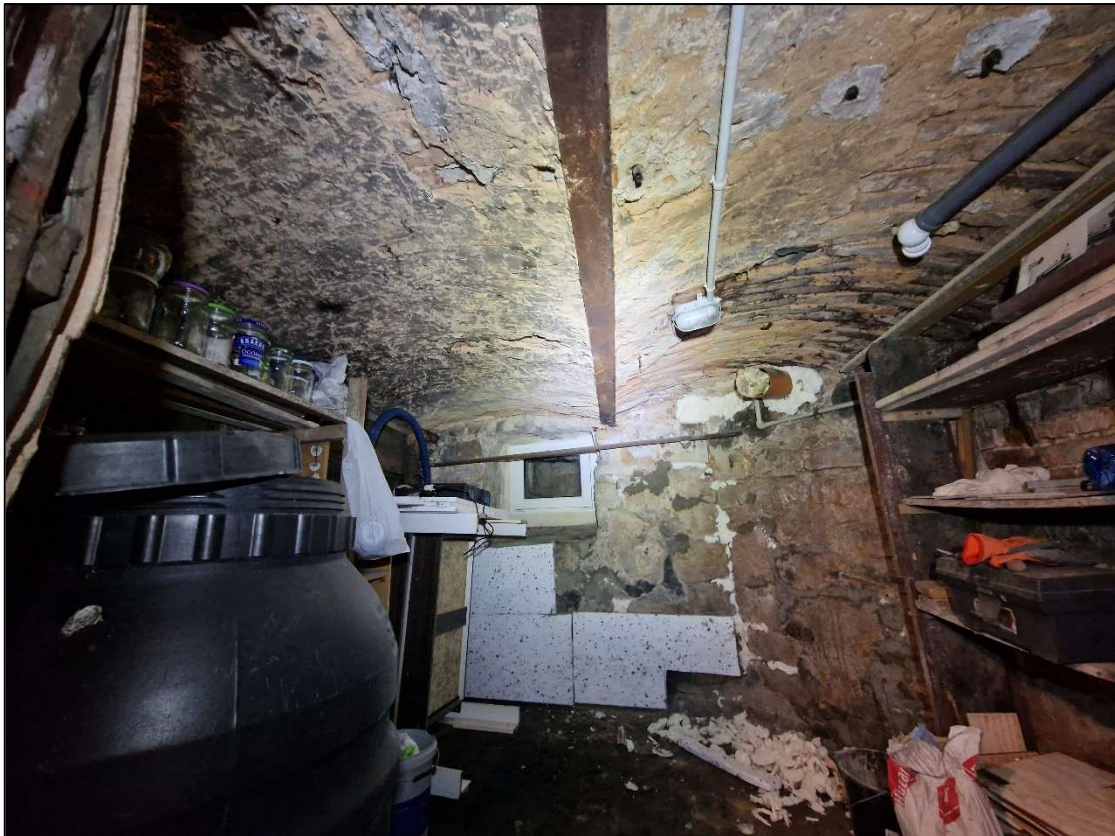
Rys 16. Ubytki i degradacja sklepień, zbutwiałe stalowe elementy stropu - pomieszczenie nr 12
