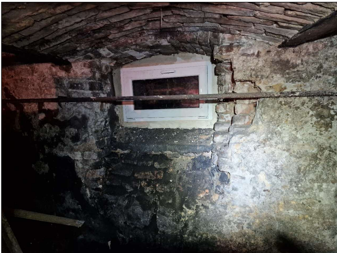
Rys 13. Ubytki ścian murowanych w rejonie nadproża okiennego
