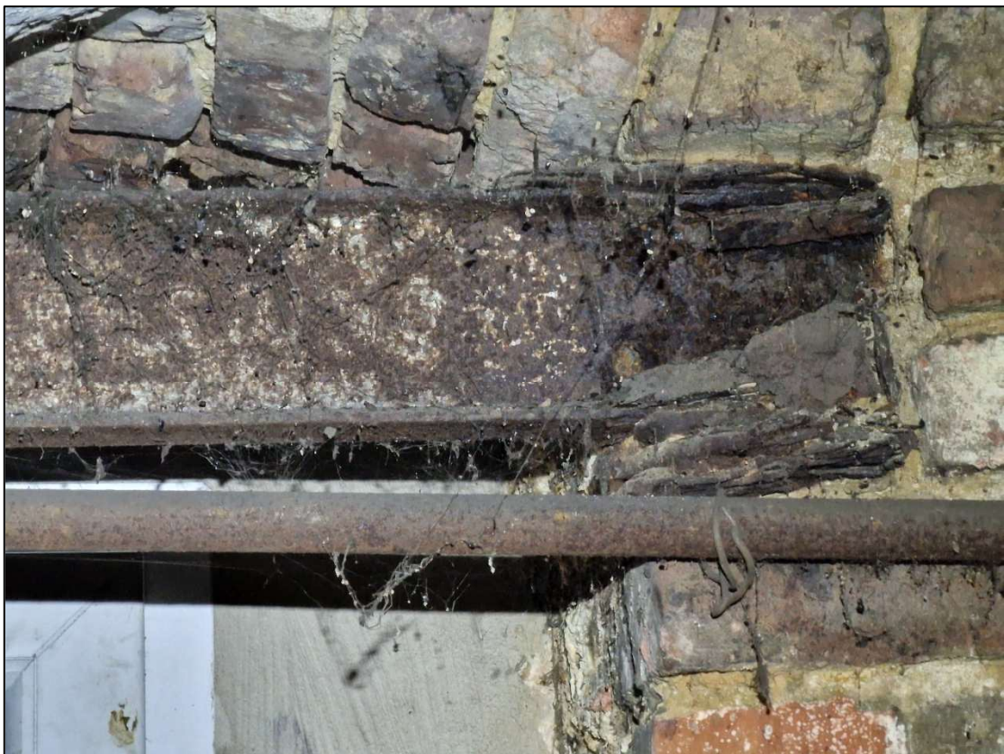
Rys 11. Przegnite stalowe nadproże okienne - pomieszczenie nr 5
