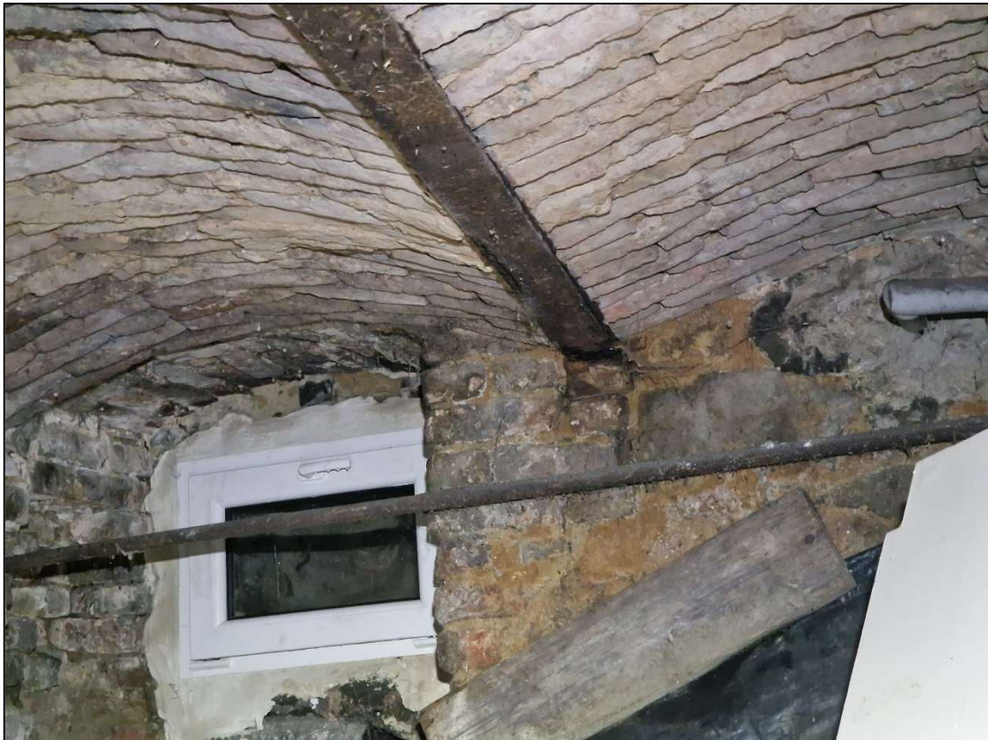
Rys 10. Ubytki i degradacja sklepień, zbutwiałe stalowe elementy stropu - pomieszczenie nr 8
