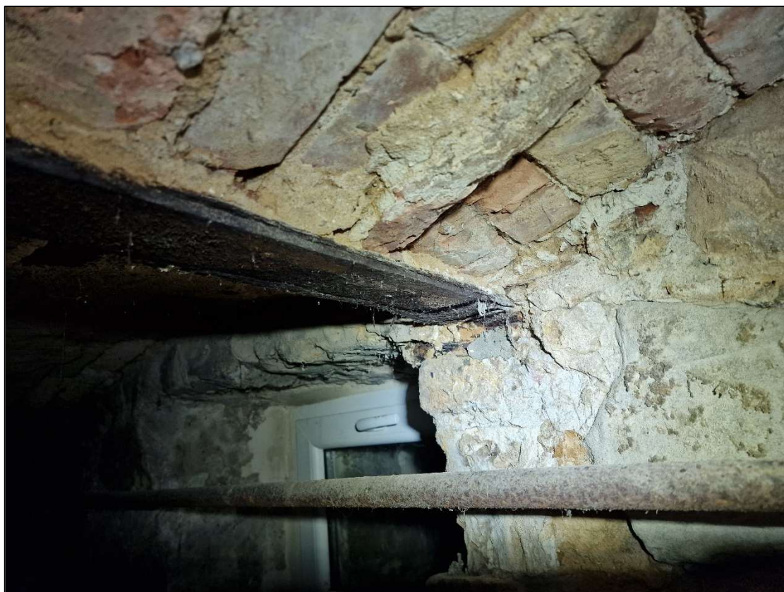
Rys 18. Ubytki i degradacja sklepień, zbutwiałe stalowe elementy stropu - pomieszczenie nr 8
