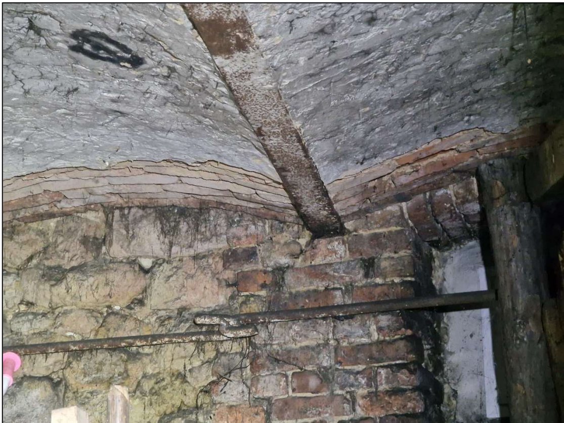
Rys 17. Ubytki i degradacja sklepień, zbutwiałe stalowe elementy stropu - pomieszczenie nr 2
