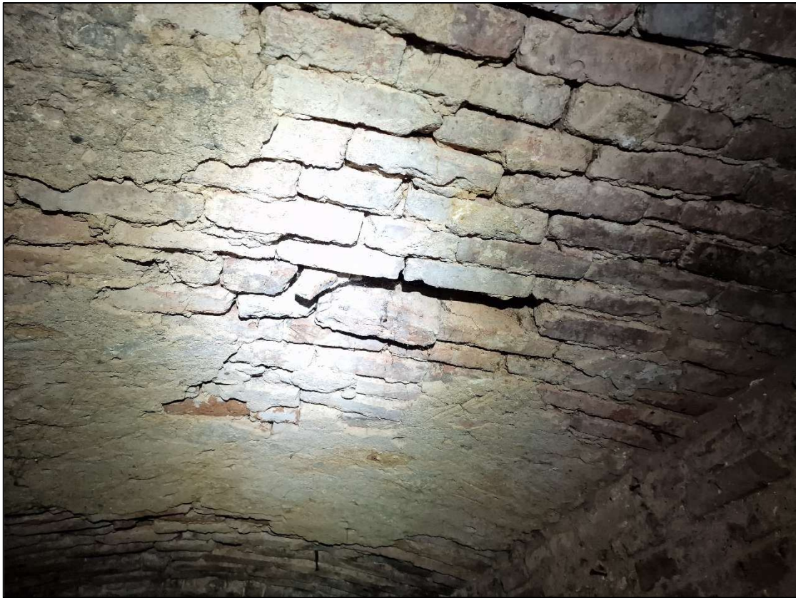
Rys 8. Silne zdegradowane i zdeformowane sklepienie ceglane w pomieszczeniu nr 10 – ubytki cegieł
