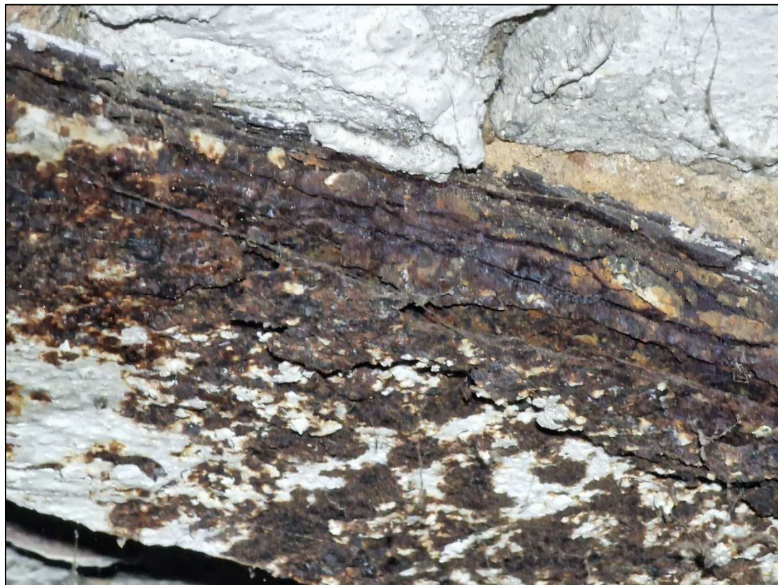
Rys 9. Silna korozja belek stalowych
